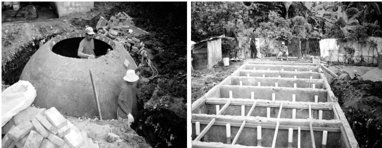
Figura 2: Digestor de biogás (izquierda) para tratamiento de flujo parcial de “aguas negras”, construcción de tabique con repellado hermético impermeable. Reactor subdividido ( baffled ), basado en los principios anaeróbicos de flujo ascendente vertical (derecha).
