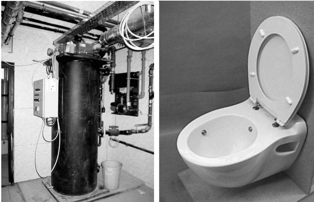
Figura 4: Estación de bombeo de vacío (izquierda) y sanitario de vacío de la unidad habitacional modelo
