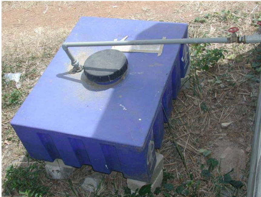
Figura 1: Mingitorios conectados a un tanque de almacenamiento fuera del edificio
