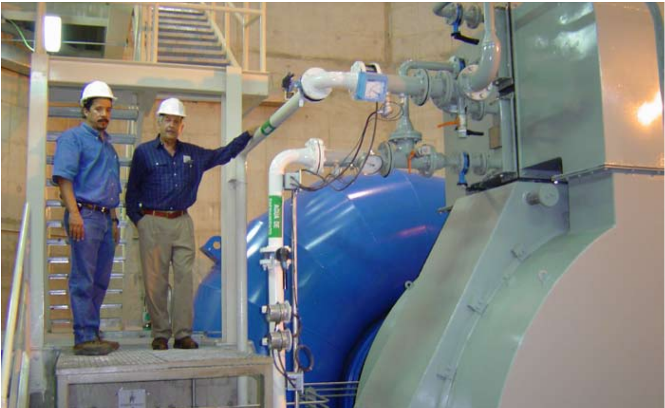
Ilustración 8. Pequeña central hidroeléctrica de Las Trojes (8 MW)
