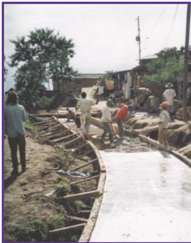
Saneamiento de barrios en Medellín: a través de la Cooperación Financiera, es posible mejorar el entorno social muchas veces responsable de los problemas ligados a la droga.
