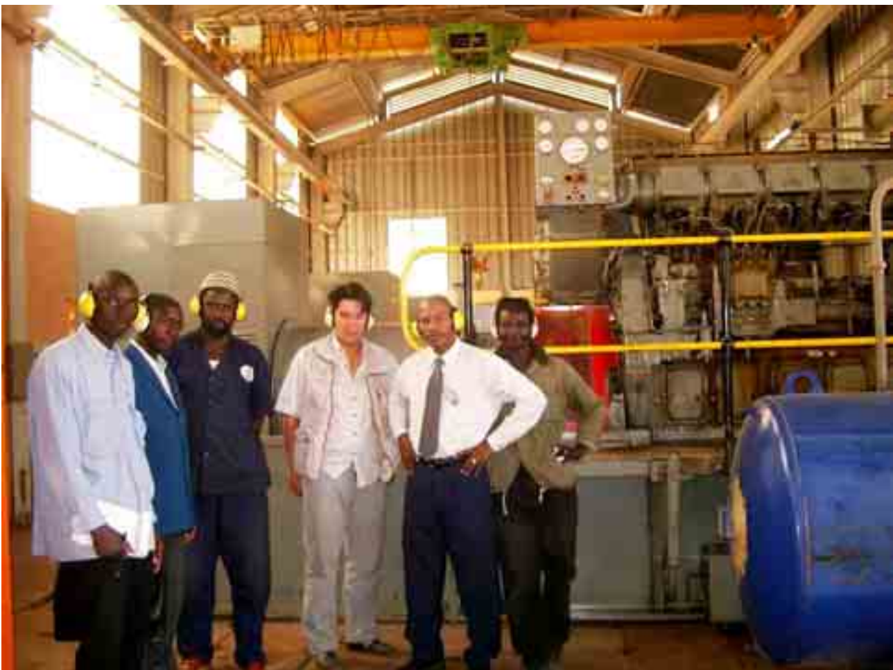
Image 3.4 Centrale thermique de Gao
