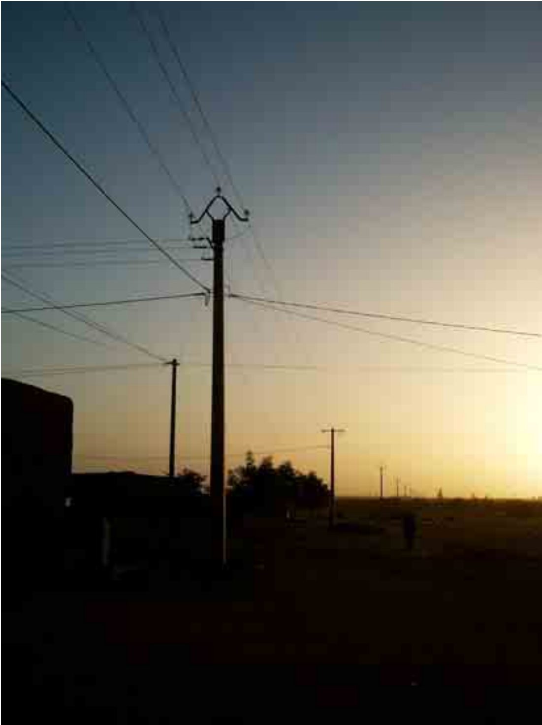
Image 4.7 Ligne aérienne 15 kV
