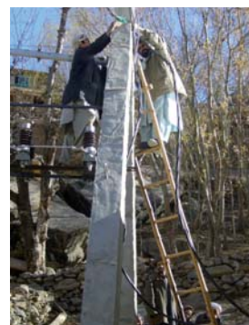
Hochspannungsmast in Sangab | Foto: GTZ
